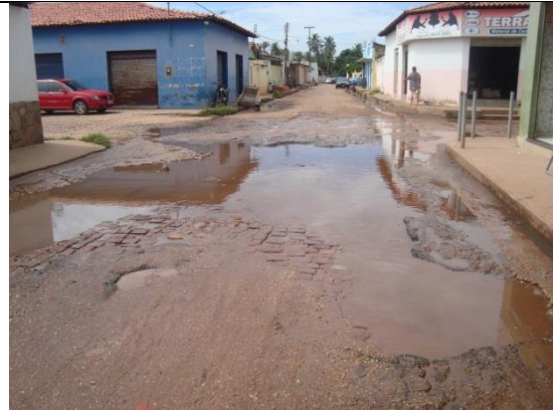
Imagem 10 – Cruzamento das ruas Antônio Nogueira de Carvalho e Quintino Custódio e o grande acúmulo de água e a situação de precária da via com buracos e lama.
