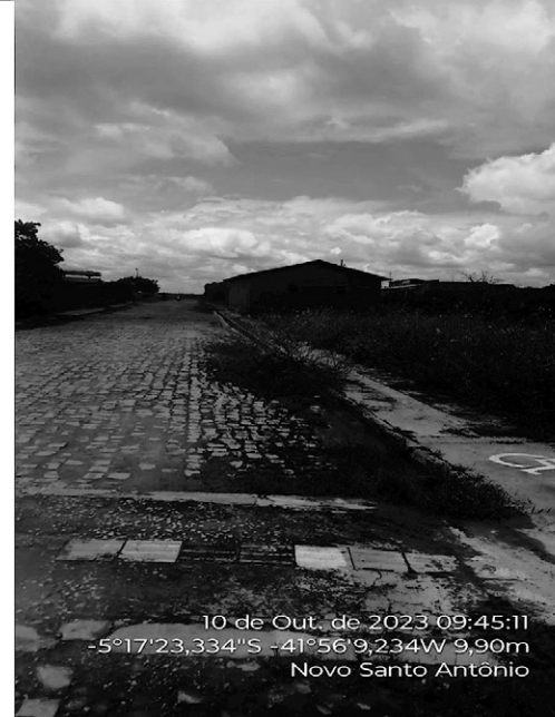
Figura 06- Rua com característica de declive sem escoamento adequado.
